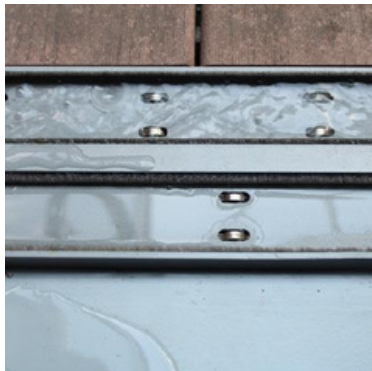
[b] Nieprawidłowy drenaż
