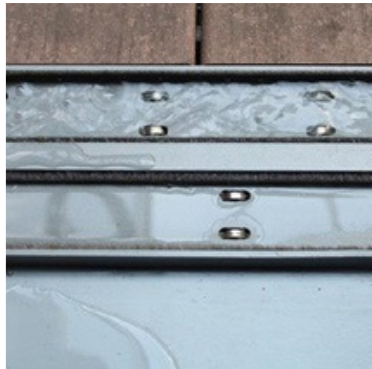
[b] Nieprawidłowy drenaż
